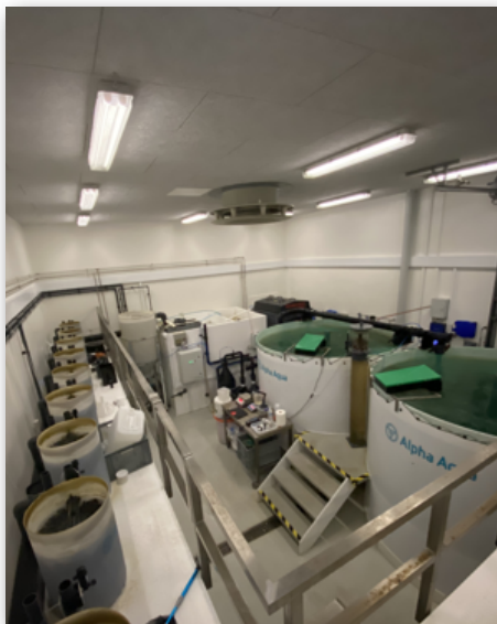
Forsøgsanlæg ved DTU Aqua, Hirtshals, med høj grad af recirkulering.
