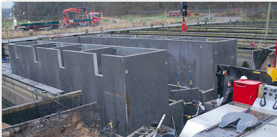
Det nye anlæg i Løjstrup er opbygget i det oprindelige damanlæg, ligesom i Rindsholm af Give Elementers L-elementer.
