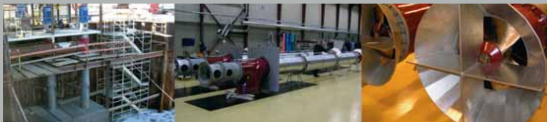
Dokpumper til skibsværft, tørdok installation.
